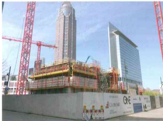
Bild 1 Mit dem Büro- und Hotelhochhaus „ONE“ entsteht eine neue Benchmark in der Frankfurter Skyline
