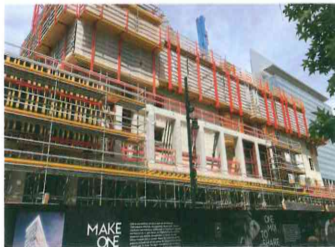
Bild 2 Stahlaussparungen für Fenster bedeuten auch bei vielfachem Einsatz nahezu keine Qualitätsverluste
