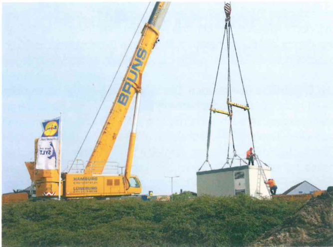
Die Last pro Trafostation betrug 45 t auf 25 m Ausladung, die maximale Hubhöhe 12 m, die maximale Hauptauslegerlänge 35 m.
