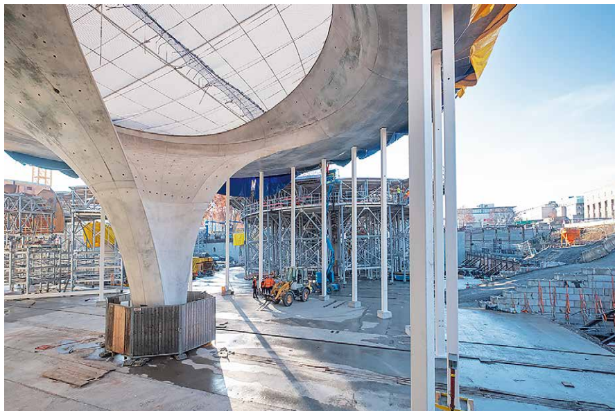
Bild 4. Nach dem Ausschalen unterstützen sogenannte Notstützen den Kelchrand so lange, bis die offenen Deckfelder zwischen den Kelchen ebenfalls betoniert und geschlossen sind. Im Hintergrund befindet sich der Rüstturm. (Achim Birnbaum)
