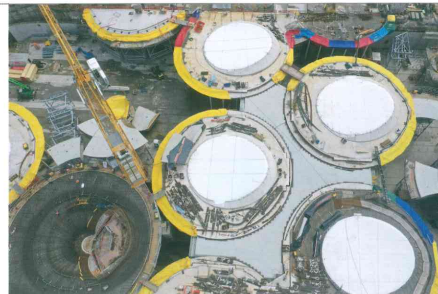
Beeindruckend: Die Schwindgassen zwischen den Kelchstützen wurden hier im zweiten Halbjahr 2020 teilweise betoniert. | Foto: DB/Malte Hombergs
