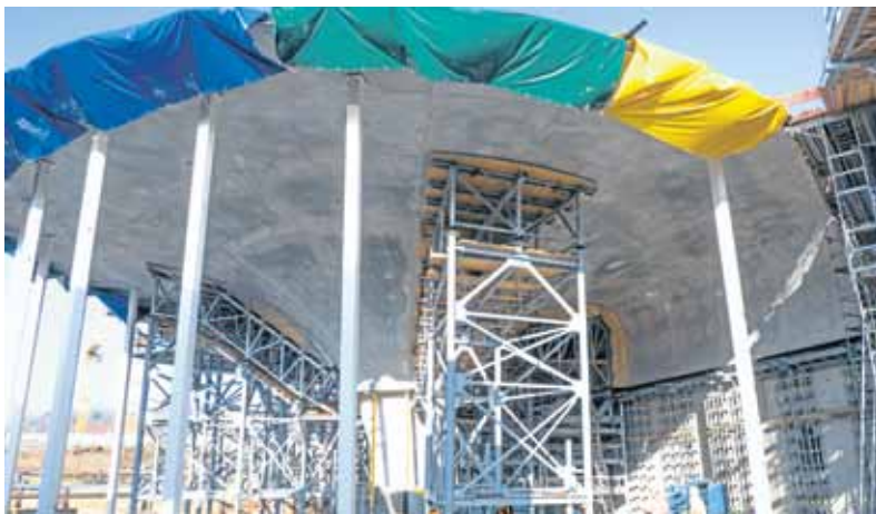
Ausschalarbeiten am ersten Randkelch: müheloses Umsetzen der tonnenschweren Rüsttürme mit dem Schwerlast-Plattformwagen.
